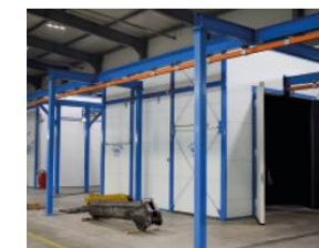
Окрасочно- сушильный комплекс
